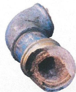
Vannrør med humus, oksider og kalk
