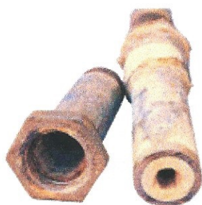
Vannrør før og etter rens
